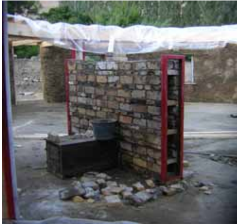
Ofen mit anschliessender Heizwand
